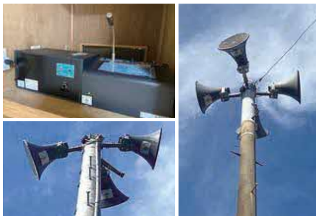
下陣内区公民館と陣内地区公民館分館に設置した放送システム
