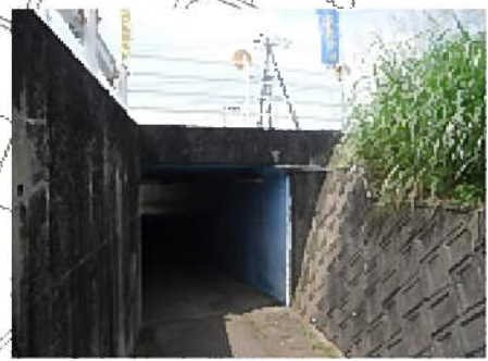
③国道の排水が落ちてくる
