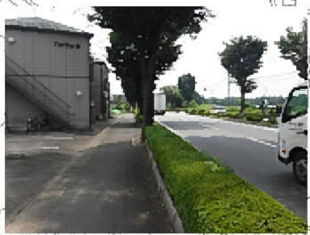
②降雨時には歩道が冠水する
