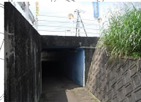
③国道の排水が落ちてくる
