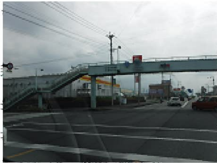
①歩道橋の舗装が劣化している
