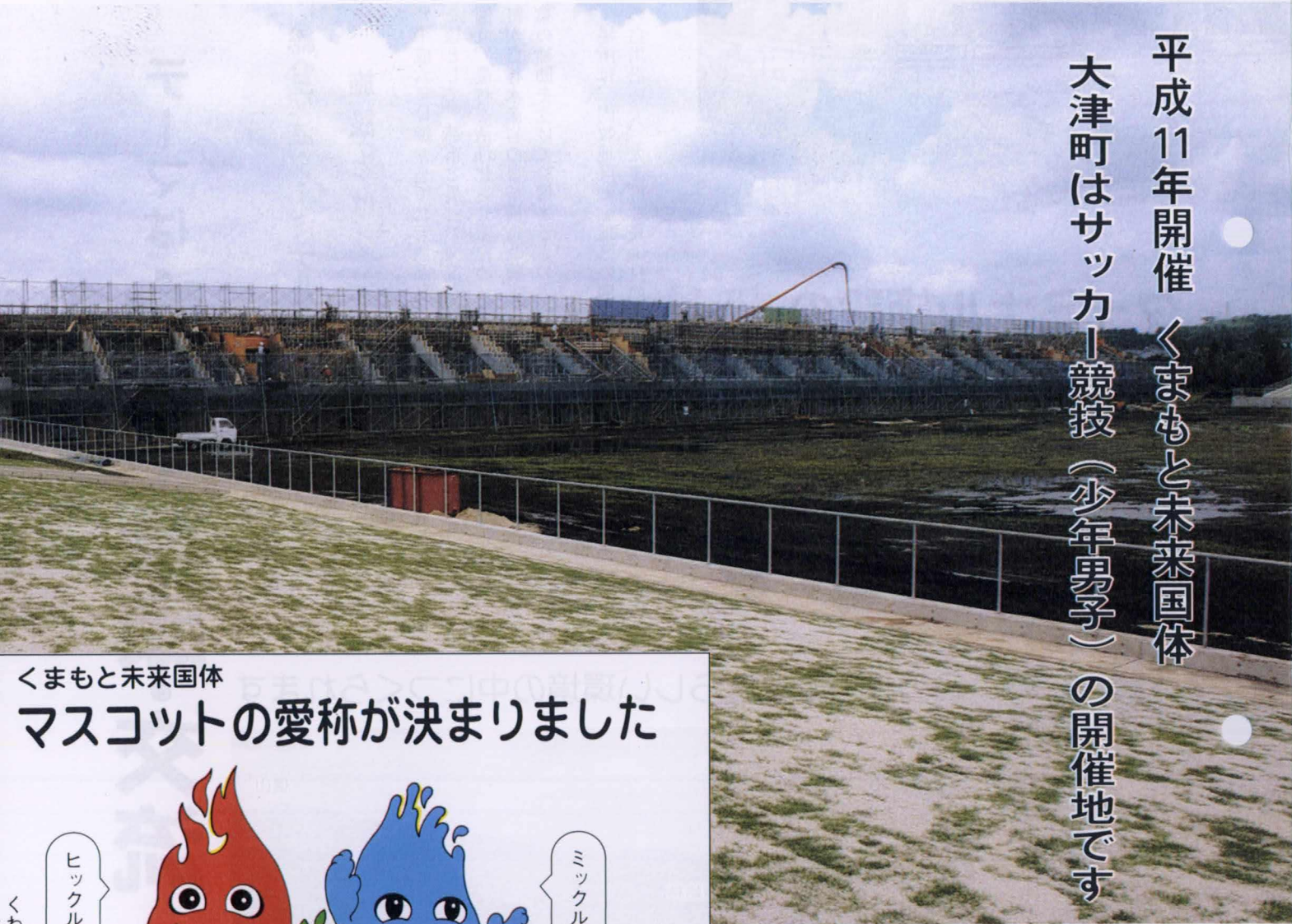
平成9年度の完成をめざして建設が進む町運動公園 (写真は球技場)
