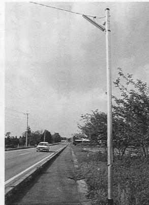
新たに設置された防犯灯 (県道矢護川大津線)
