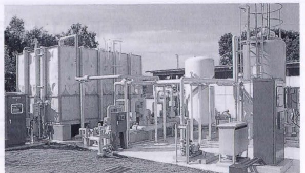
本田技研工業（株）熊本製作所の雨水利用施設
