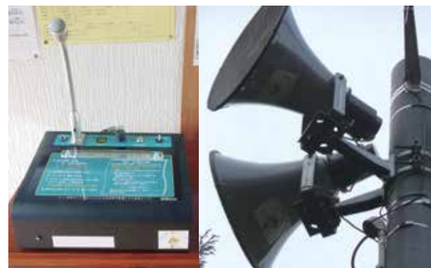
真木区に新たに整備されたコミュニティ無線放送システム
