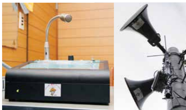
両地区に整備されたコミュニティ無線放送システム
