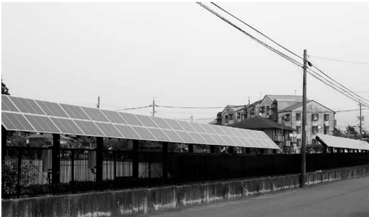
↑ 大津中央公園に設置されている太陽光パネル
