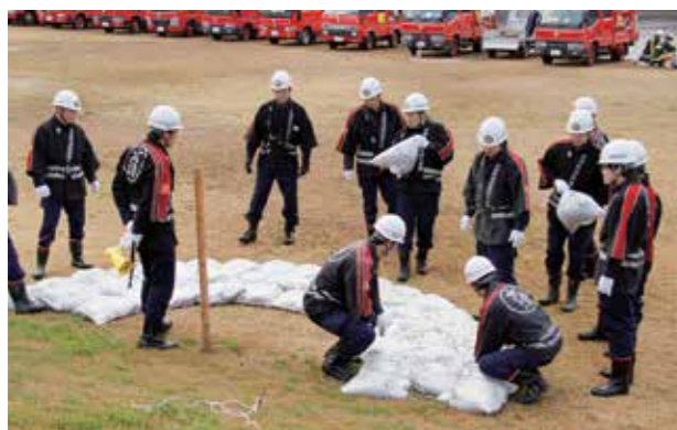
堤防に穴があいて漏水した場合に、川の水位との水位差を縮めて水の圧力を弱め、堤防が壊れてしまうのを防ぐ「月の輪工法」
