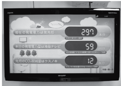
発電モニターを見ると、現在の発電電力が蛍光灯何本分に相当するのかなどが分かります
