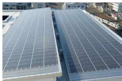
▲太陽光発電パネルを使った再生可能エネルギー活用（イメージ）
