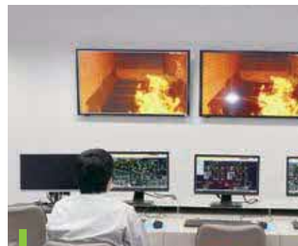
施設全体を管理する中央制御室。ここでゴミの搬入や焼却炉内部、ゴミピット内のようすを確認する
