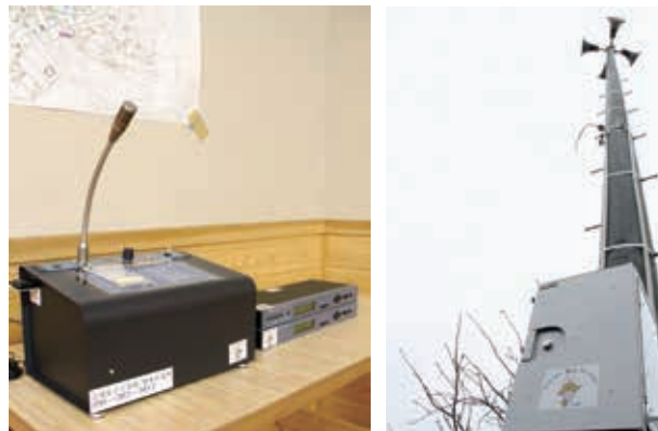
桜丘団地自治会に整備されたコミュニティ無線放送システム
