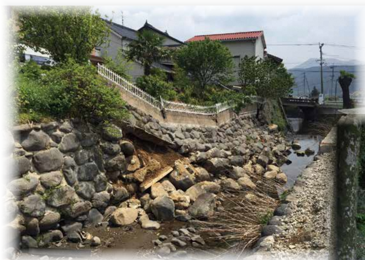
下井手水路の被災状況（当時）
