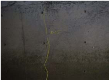
橋台：ひびわれ
