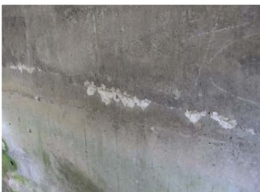
橋脚：漏水・遊離石灰
