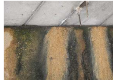
橋台：漏水・滞水
