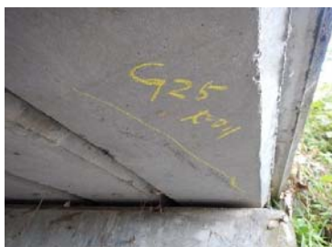
主桁：ひびわれ
