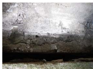
横桁：ひびわれ，うき
