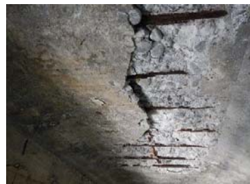
床版：剥離・鉄筋露出
