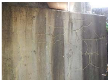
橋台：ひびわれ
