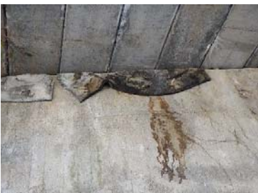
支承部：支承の機能障害
