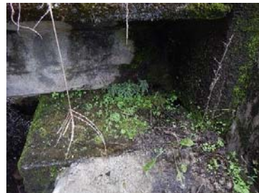
支承部：土砂詰り
