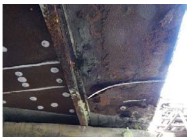
床版：腐食，防食機能の劣化
