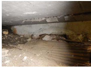
橋台：その他(石材抜け落ち)
