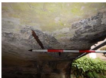
床版：剥離・鉄筋露出
