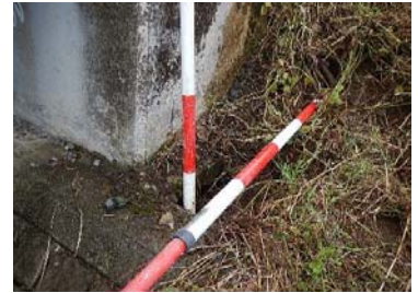
橋台：その他(土砂流出)
