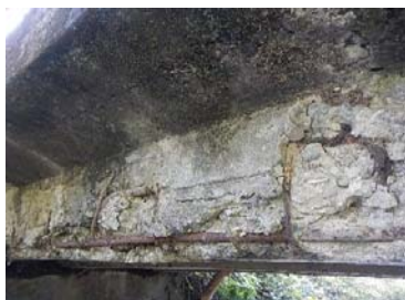
主桁：剥離・鉄筋露出
