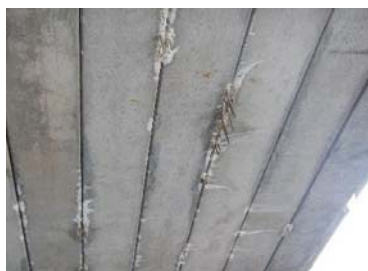
床版：漏水・遊離石灰
