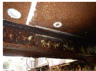
主桁：腐食，防食機能の劣化
