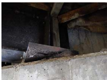
支承部：腐食，防食機能の劣化
