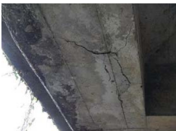
主桁：うき，ひびわれ
