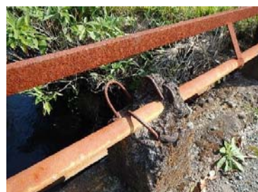
防護柵：剥離・鉄筋露出
