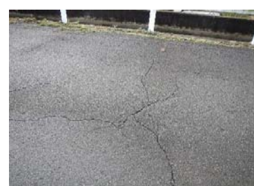
橋面：舗装の異常
