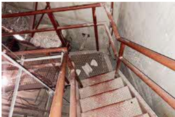
文化ホールの天井裏のブロック壁の一部の剥離と落下
