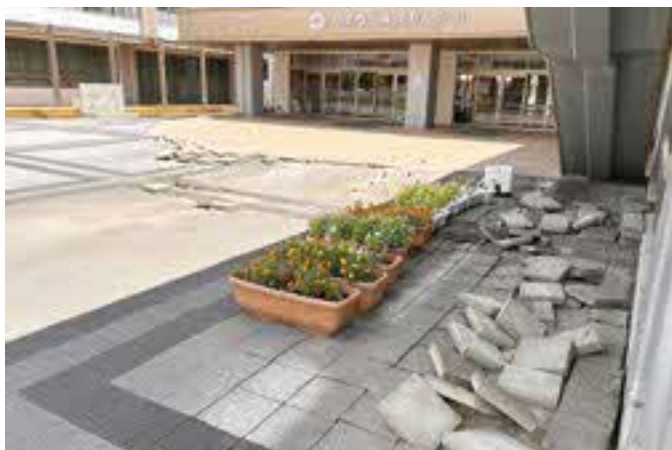
美咲野小学校入口のインターロッキング破損
