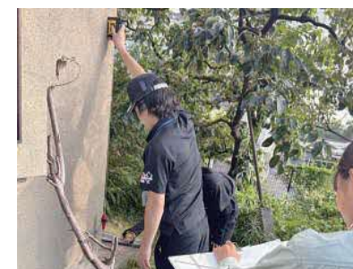
住家被害認定調査
