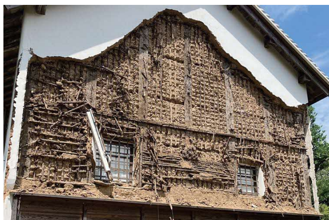
国指定重要文化財 江藤家住宅「中の蔵」の崩落した土壁
