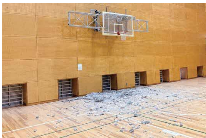
天井の落下（町総合体育館サブアリーナ）
