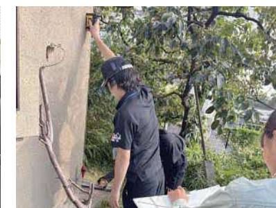
住家被害認定調査
