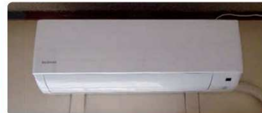
▲設置されたエアコン
