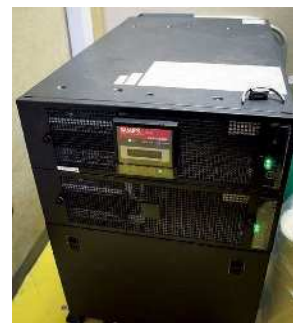
老人福祉センターの非常用電源
