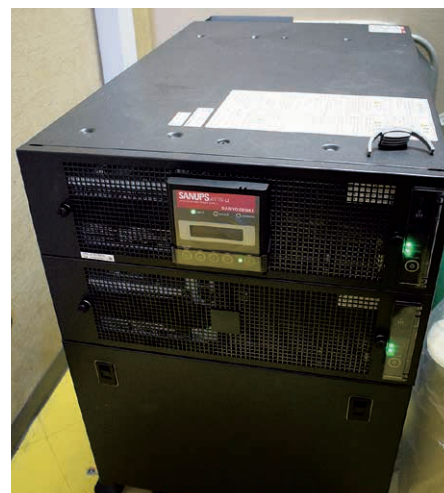
老人福祉センターの非常用電源
