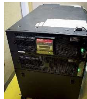
老人福祉センターの非常用電源
