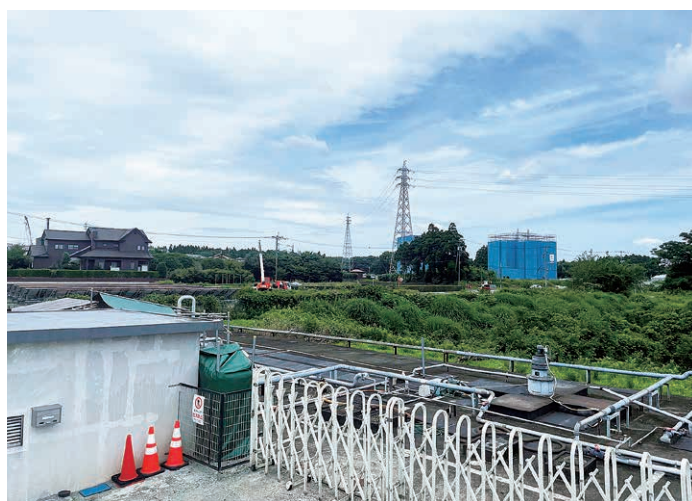
つつじ台区 污水处理施設
