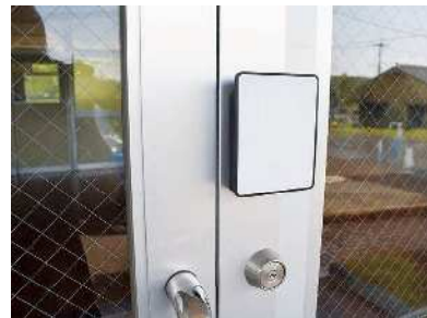
旧矢護川川体育館のリモートロック
