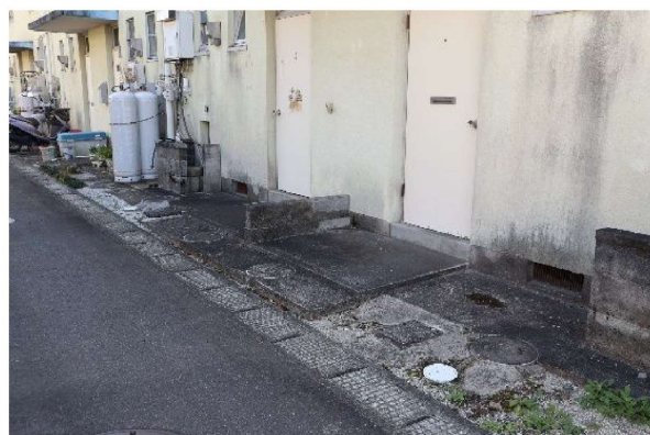
玄関ポーチ部の段差・外壁の汚れ（西嶽団地）
