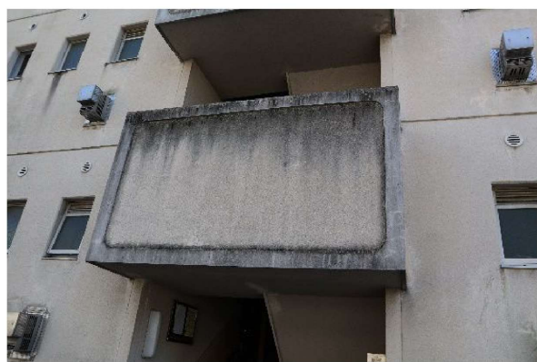
外壁の汚れ・一部クラック（あけぼの団地）
