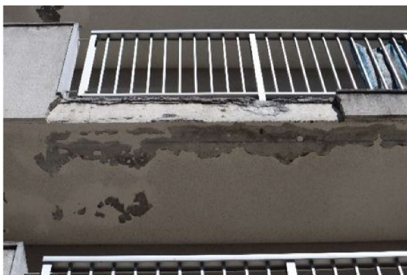
バルコニー裏部の鉄筋露出（あけぼの団地）
