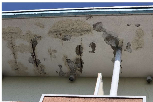
屋根底裏の鉄筋露出（西嶽団地）
