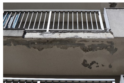
バルコニー裏(コンクリートの爆裂)
