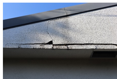
妻壁(コンクリート破損)
