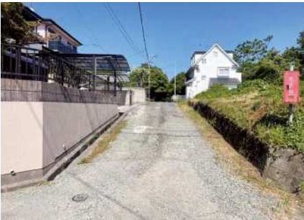
桜丘区内の舗装が劣化している道路
