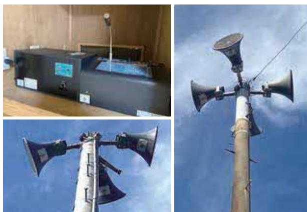
下陣内区公民館と陣内地区公民館分館に設置した放送システム
