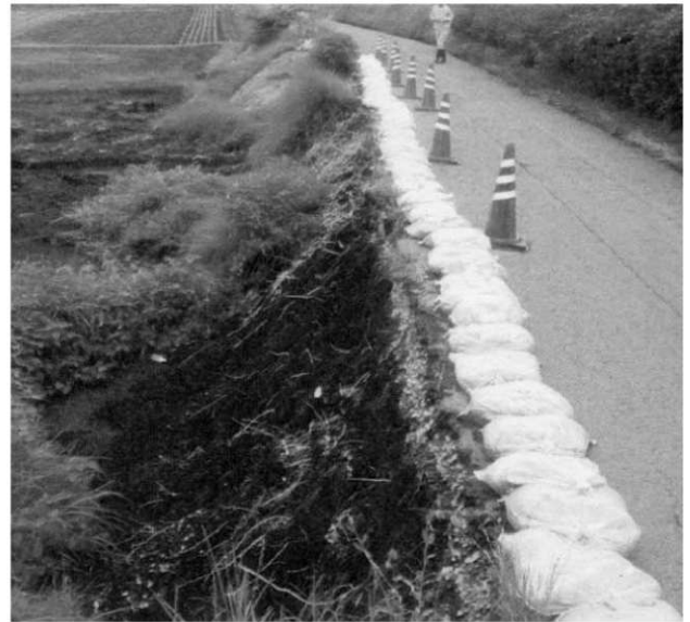
土手がくずれた町道瀬田駅吹田線
