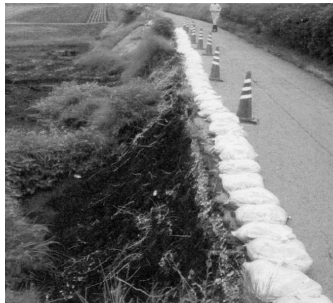
土手がくずれた町道瀬田駅吹田線
