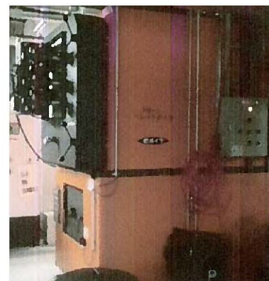
岡山県真庭市役所 ペレットボイラー（冷暖房）
