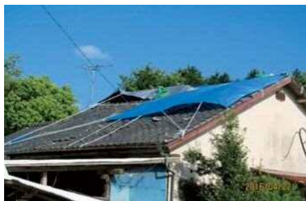
瓦が落ちて一部損壊が多い
