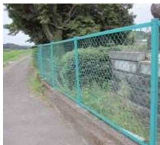
大津東小学校フェンス
