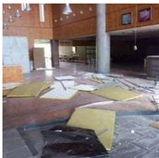
被災した岩戸の里温泉内部
