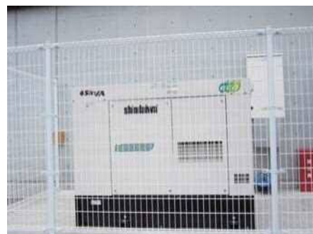
総合体育館自家発電装置 今回の地震による停電で稼動。停電の 時間は短かったが、手ごたえがあった。
