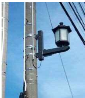
電柱に設置された照明灯
