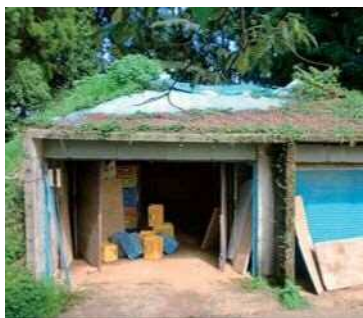
被災したからいも貯蔵庫
