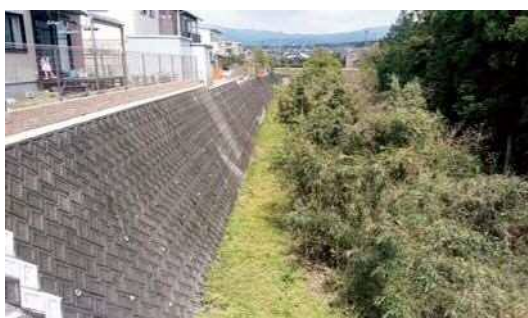
美咲野団地一丁目の盛土造成の崩落現地
