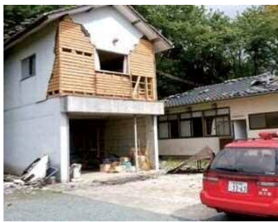
被災した積載車倉庫
