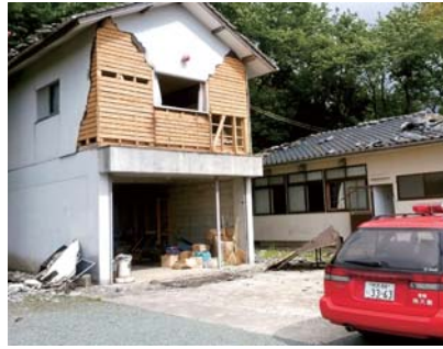
被災した積載車倉庫
