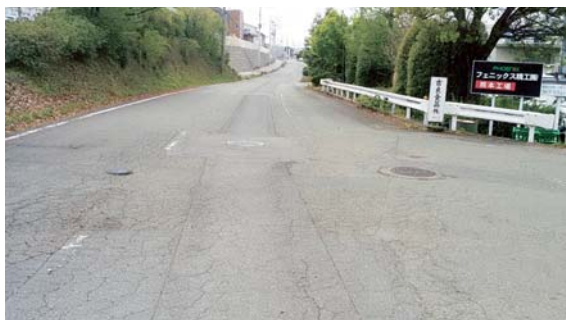
室工業団地入口町道の下水道のくぼみ
