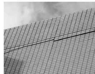
外壁タイル破損
