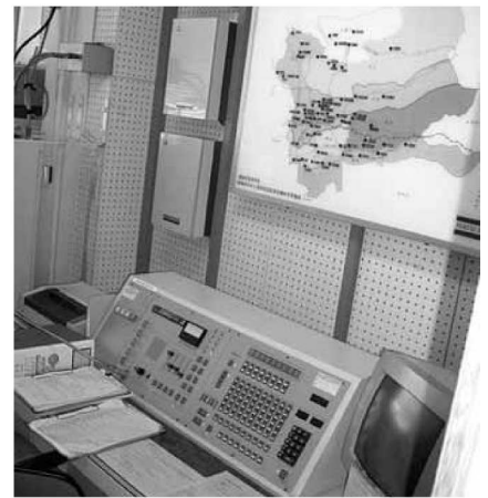
防災行政無線設備
