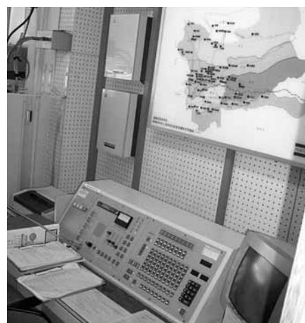
防災行政無線設備
