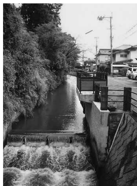
起伏式ゲート（塘町の人工堰）
