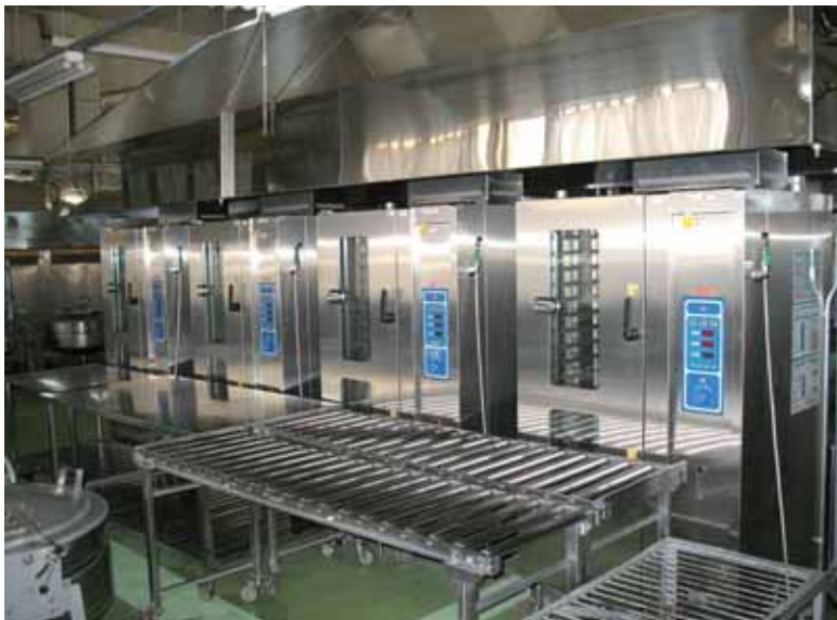
給食センター整備 スチームコンベクションオープン
