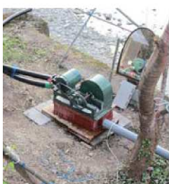
小水力発電実験
