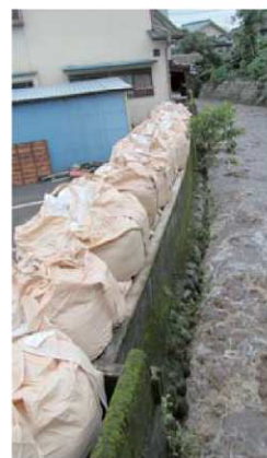
水害で決壊した護岸（室） 上井手は、菊陽町から下流は堀川ですが、大津町から上流は、町所有の農業用水路です。（法定外公共物）
