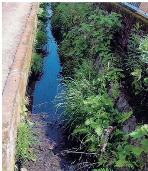
悪臭がする水路
