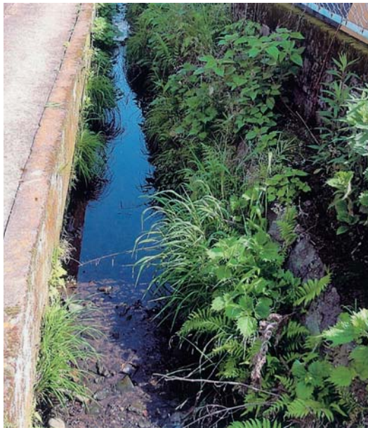
悪臭がする水路
