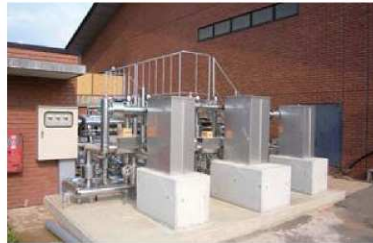
総合交流ターミナル機械設備
