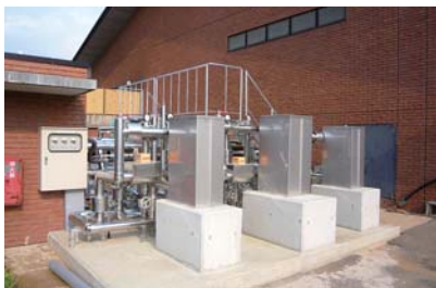
総合交流ターミナル機械設備
