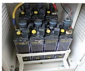
災害無線用電池
