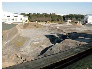
楽善埋立処分場
