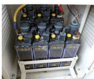
災害無線用電池
