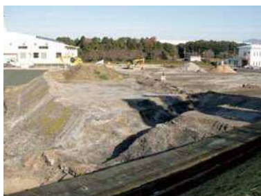
楽善埋立処分場
