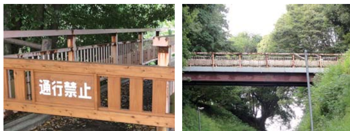
腐食した連絡歩道橋
